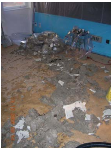
Bild 36. Rivet material på golvet.
