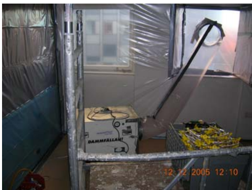
Bild 30. Fläkten för undertryck renar luften och blåser ut den utanför huset.
