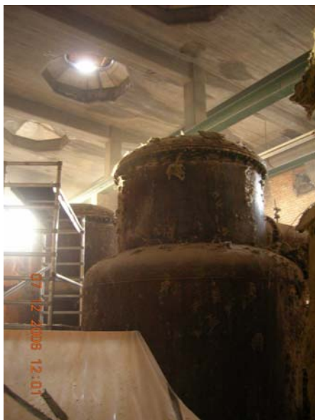
Bild 10. Bilden är tagen på översta våningen och visar en av de sanerade induktionspannorna.
