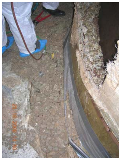
Bild 19. Det mesta av isoleringen lades direkt i avfallspåser men en del hamnade på golvet.
