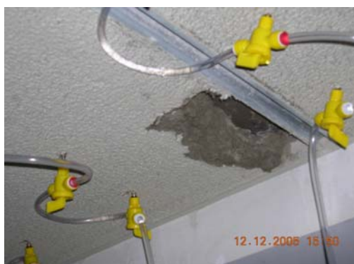
Bild 33. På bilden syns att isoleringen har blivit genomvätt.
