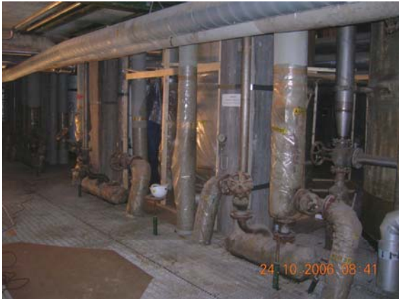
Bild 12. I mitten av bilden ses den panna saneringen utfördes på.
